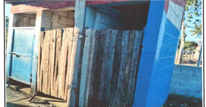
Foto 4: Las puerta de los baños ya se caen debido al mal estado de la madera.
