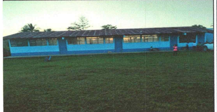
Foto 2: El techo del centro educativo se encuentra en mal estado, con agujeros y oxido.
