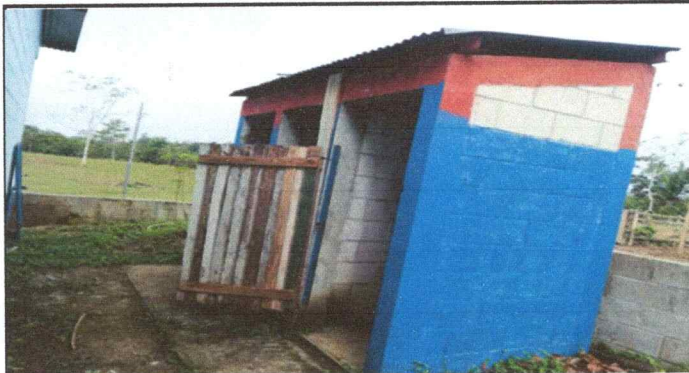
Foto 3: Las puertas de los sanitarios no estan buenas, son de pedazos de tabla en mal estado.
