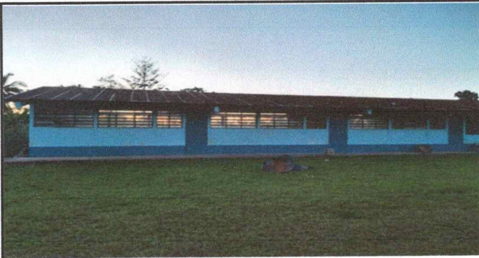
Foto 1: Se puede ver el mal estado de las láminas que tiene el centro educativo.
